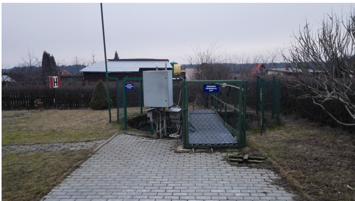
Zdjęcie nr 3: Oczyszczalnia ścieków komunalnych w miejscowości Łubiana – eksploatowaną przez „Lubeko” Sp. z o.o – zbiornik generacji LKT
